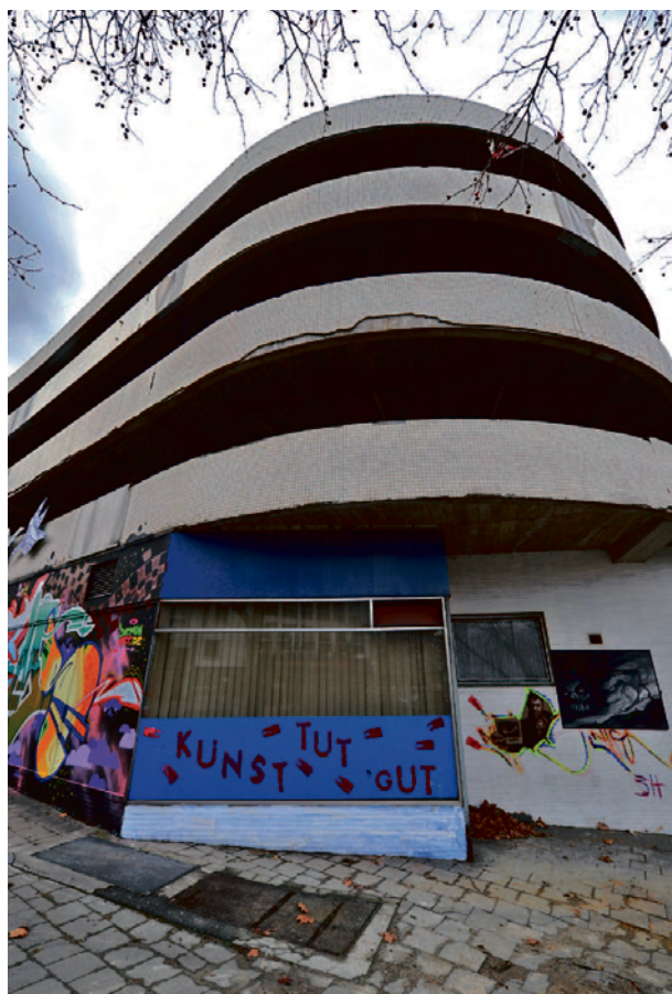
Das Parkhaus an der Rottstraße ist marode. Im Spätsommer soll es nun endgültig abgerissen werden.
