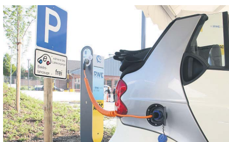
Säule und Auto verbinden, schon fließt der Strom.
